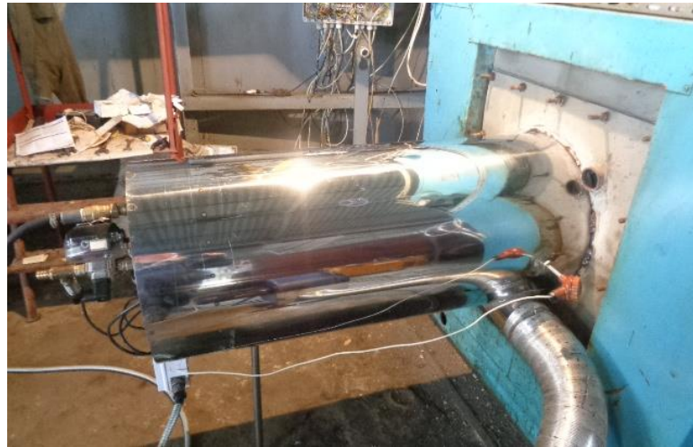
Рисунок 2.36 – Дослідний зразок пальникового пристрою для спалювання композиційних палив, встановлений на паровому котлі
